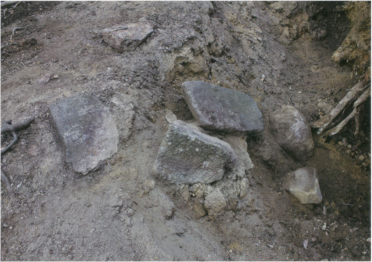
1 貼石毀損状況（東から）
