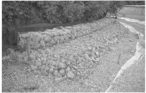
4 布団籠設置状況
