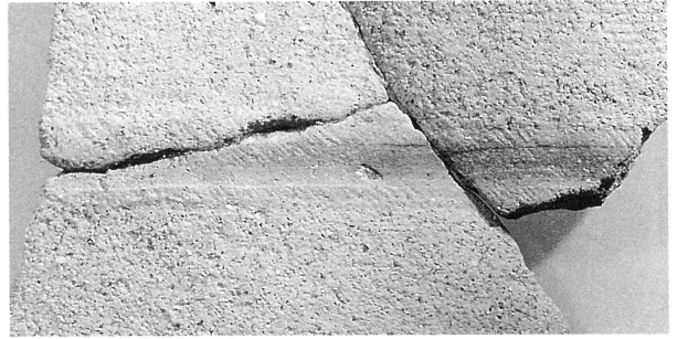
2 同 突帯剥離部
